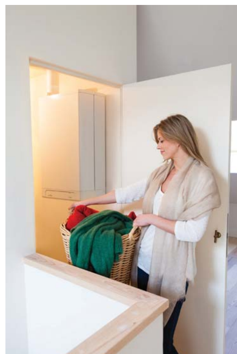
Obstoječa plinska kondenzacijska peč
